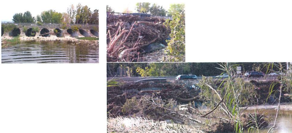
FIGURE 30 : EXEMPLE D'OBSTRUCTION DES BUSES DE L'A8 LORS DE LA CRUE DU 03/10/15
