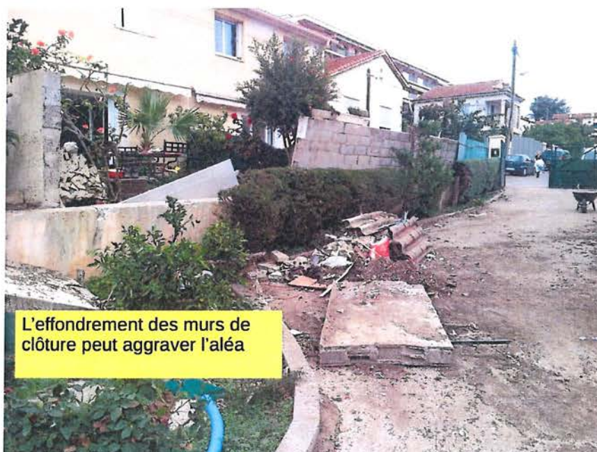
FIGURE 35 : EFFONDREMENT D'UN MUR SUITE À L'INONDATION
